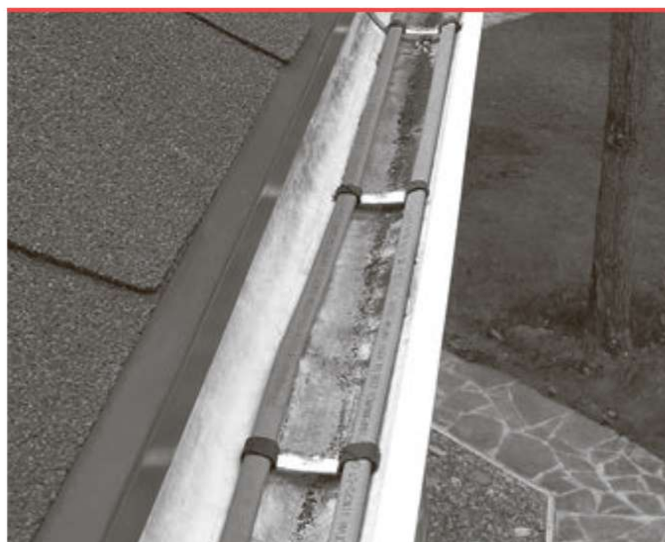
6 водосборные лотки (водосборные желоба)
